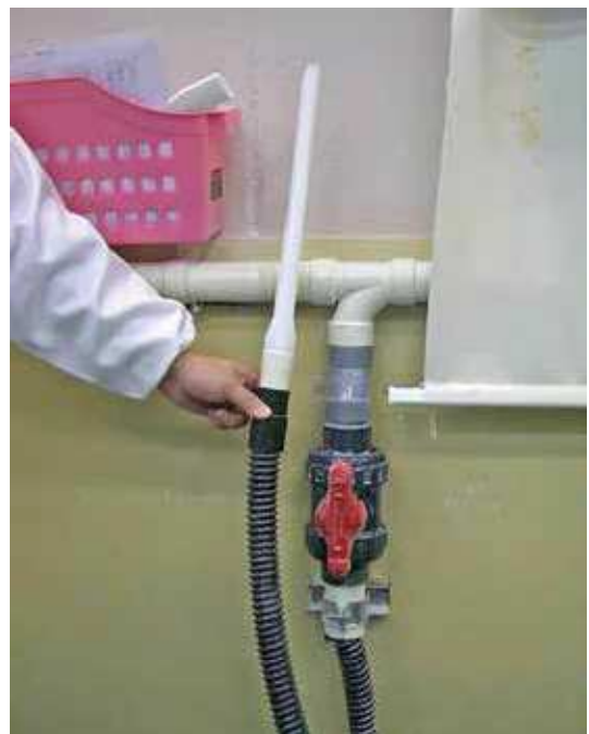
ビルトイン式の吸引掃除機の使用例
