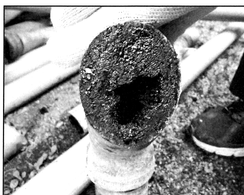
写真 3 定期清掃不可の排水管
