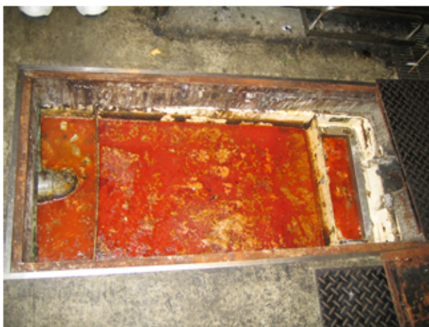
図 13 管理不良の事例
