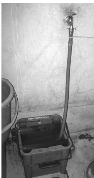
ホースが接続された給水栓
