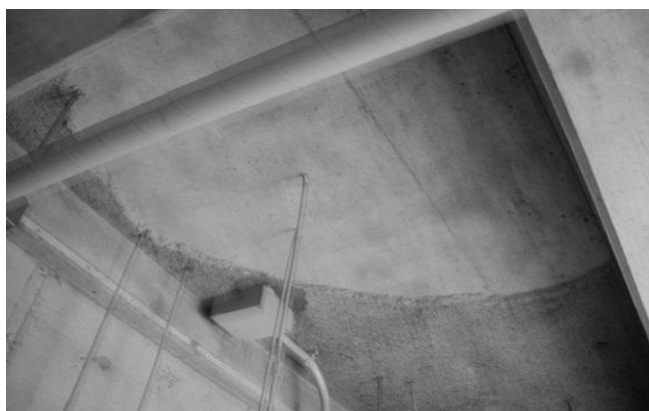
天井の一部が落下
