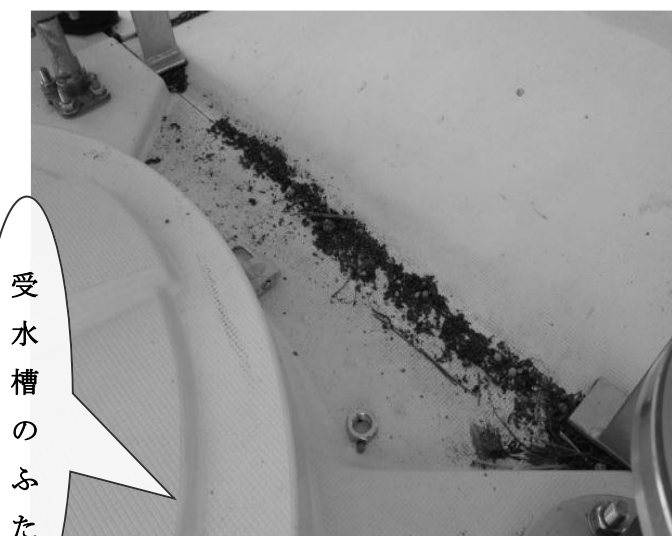
受水槽上部の土砂の堆積
