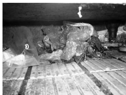
厨房機器下の清掃不良
