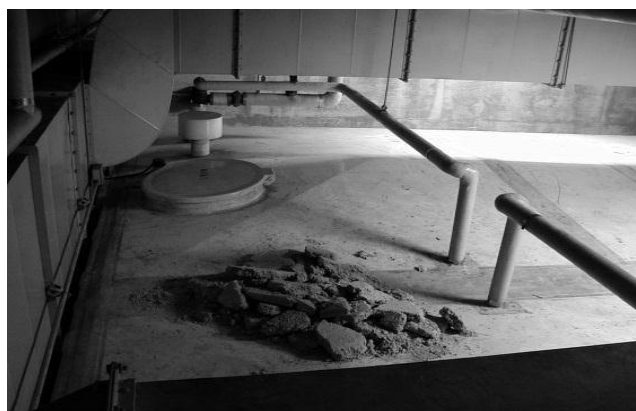
受水槽上部の落下物
