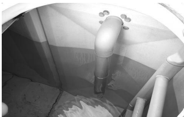
給水管の水没（不良例）
