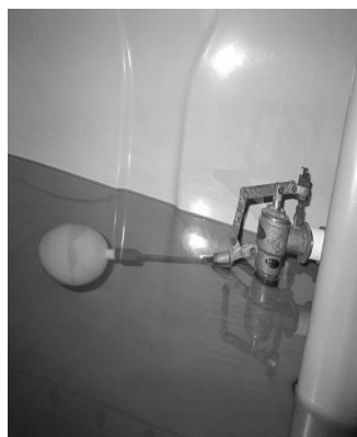
ボールタップ・給水口ともに水没
