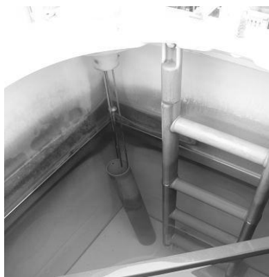
電極棒の波消し管の脱落
