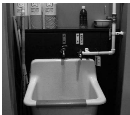
写真5 SKに検水栓を設けた例
