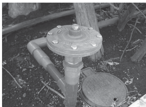
写真 2 バキュームブレーカ
